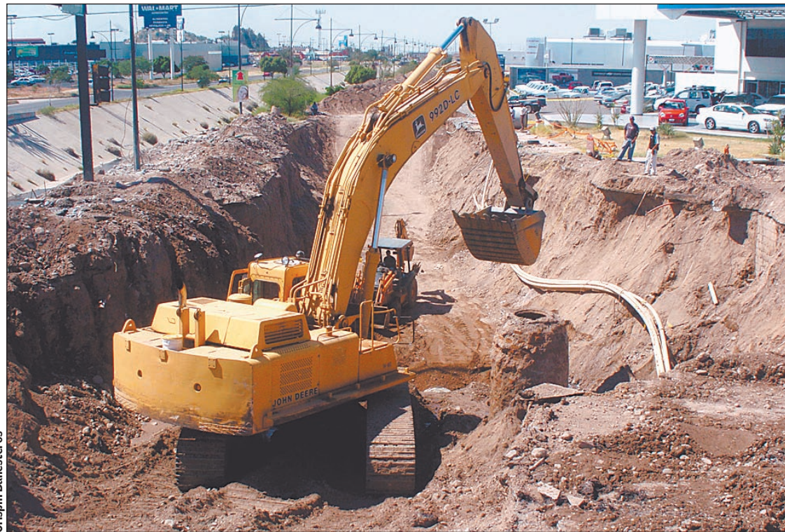
Un gran hundimiento se ha presentado en el área de Reforma y Colosio, donde se repara un colector de drenaje; esa área se encuentra a un costado del canal del Vado del Río.
