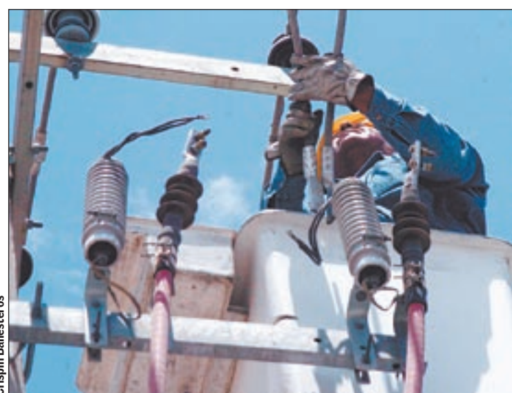
El vandalismo afecta al servicio de electricidad y, de acuerdo a la CFE, los problemas en el suministro de energía en el Norte de la ciudad se debieron a que se cortaron cables de alta potencia.
